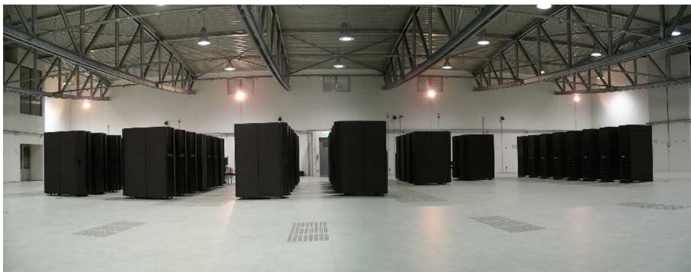
Blick in die neue Maschinenhalle mit dem IBM-Supercomputer
