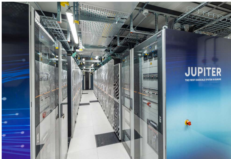
Einer der sieben IT-Räume für Racks des JUPITER-Boosters
